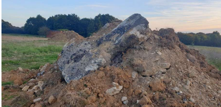
8. Buttes de gravats issus des bâtiments détruits
